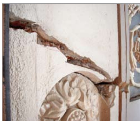
Трещина на штукатурке орнаментов
