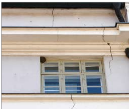
Широко раскрытые трещины на фасаде
