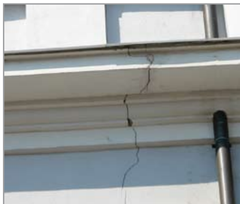
Трещина на фасаде
